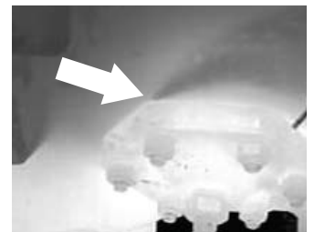
“嗅探器”在用于气体检测时无法追踪泄漏来源，而这张热图像却能够清晰显示泄漏来源在左侧。
